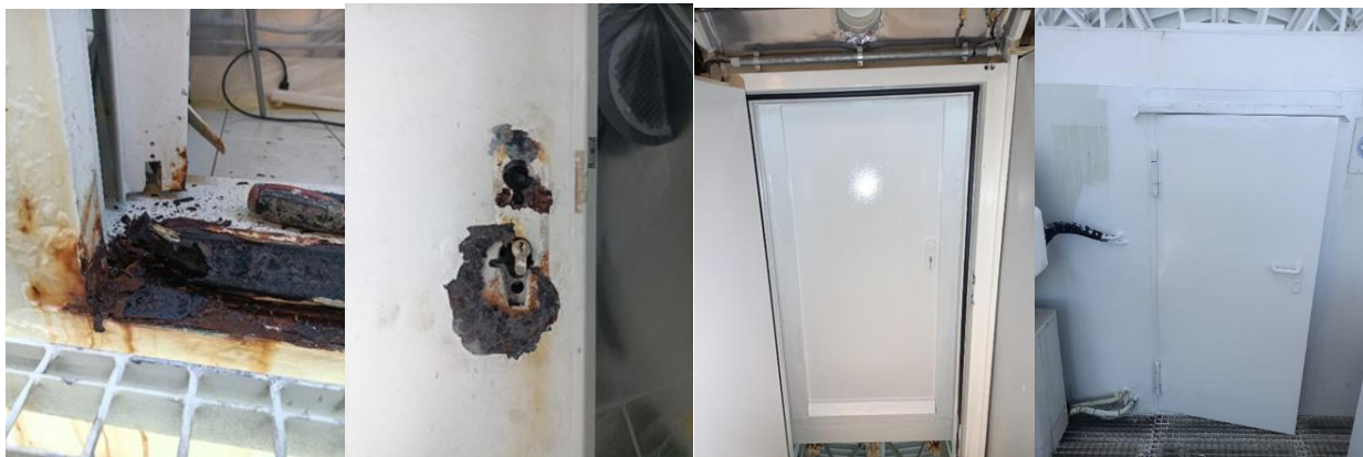
Figura 09 - Zonas de corrosão na porta da cabine do radiotelescópio e respetivos trabalhos de manutenção
