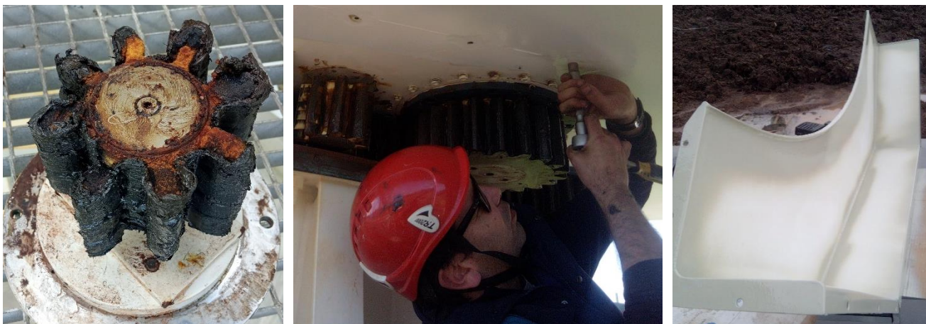
Figura 9 – Pinhão de lubrificação danificado; Remoção de parafusos partidos; Pintura dos painéis de acesso
