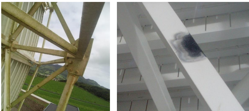
Figura 10 – Acumulação de limo verde no radiotelescópio; Limpeza de corrosão de uma viga estrutural do radiotelescópio
