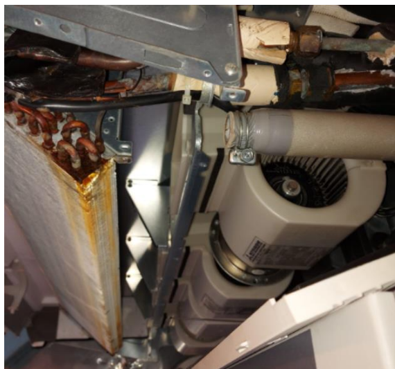
Figura 8 – Condição da máquina interior do AVAC instalado na cabine de azimute do radiotelescópio
